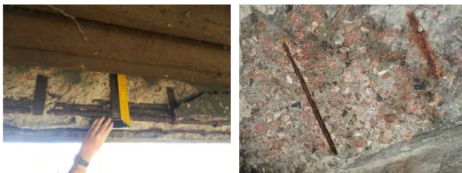
Rys. 11-12. Korozja żelbetu belek i płyty pomostu
