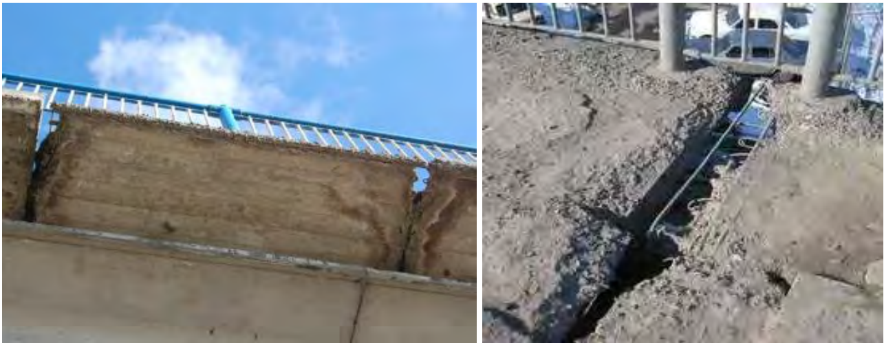
Рис. 14. Руйнування залізобетонної тротуарної плити (міст по вул. Рівненській)
