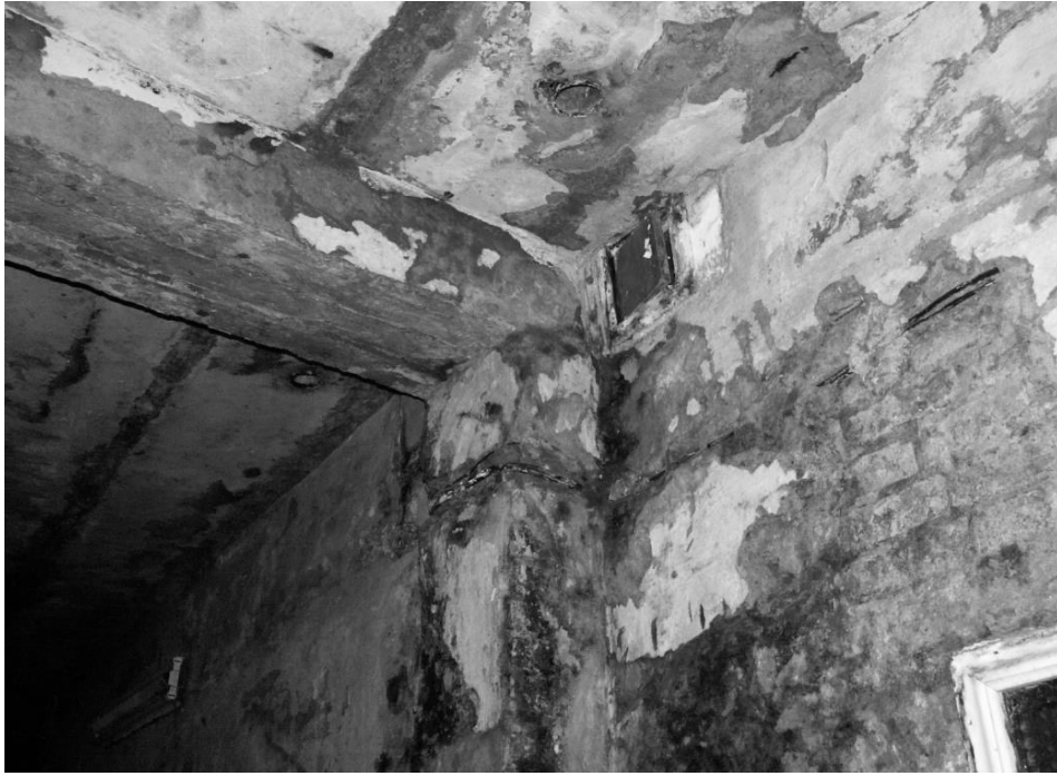
Рис. 3. Пошкодження залізобетонного покриття біокорозією
