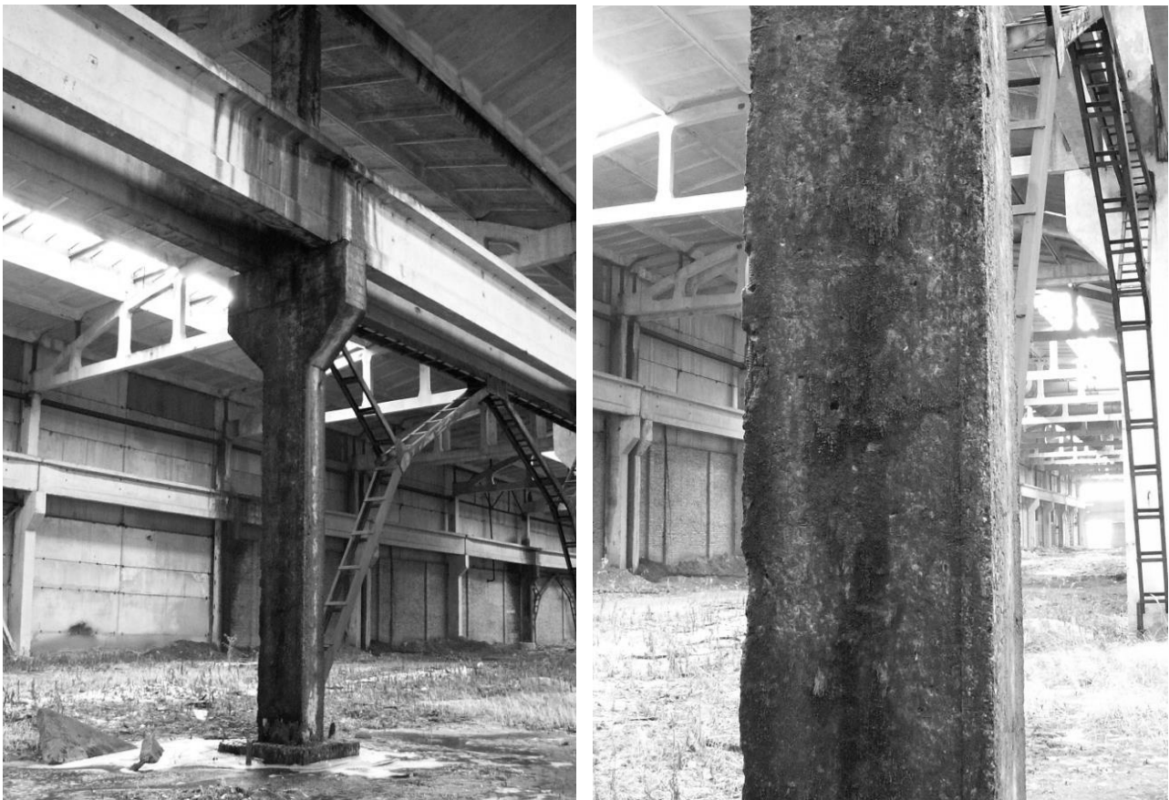
Рис. 2. Пошкодження залізобетонної колони та підкранових балок біокорозією
