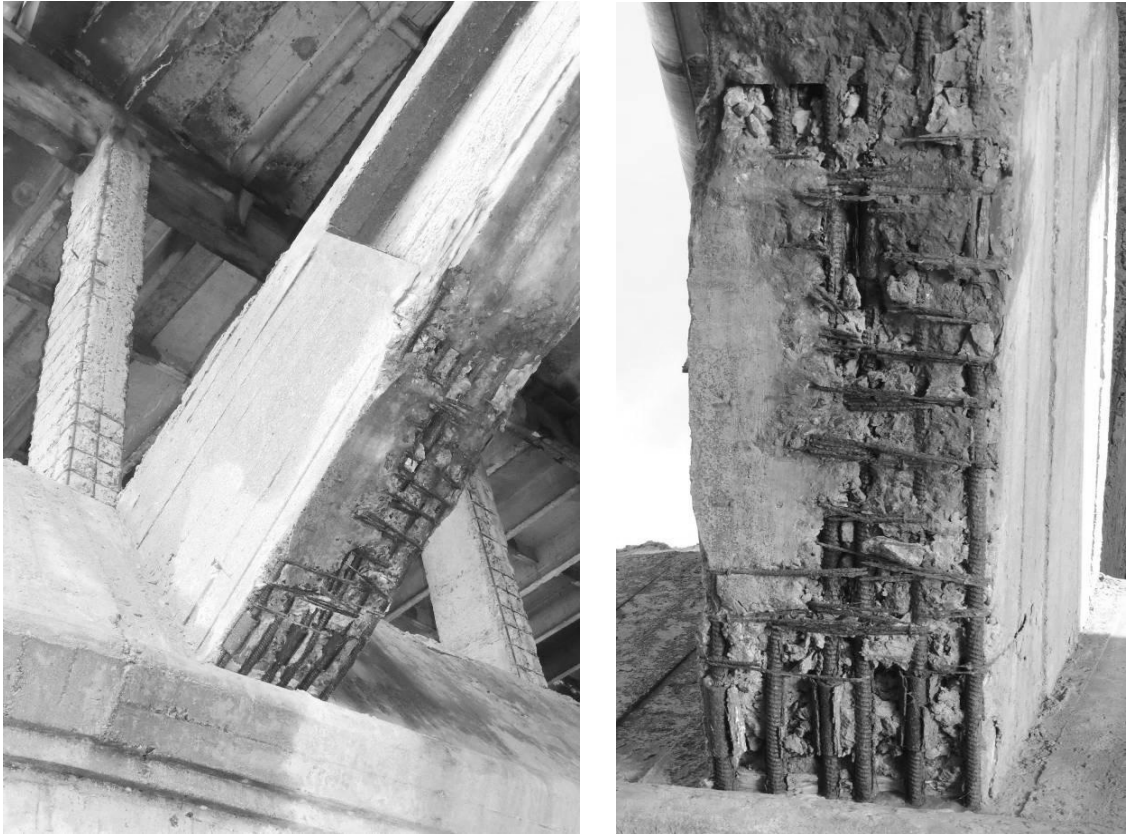
Рис. 4 – Пошкодження захисного шару бетону з оголенням та корозією арматури в п'яті арки через дефекти виготовлення, а також суцільне відшарування захисного шару арматури колони рами надбудови опори мосту (фото зліва)
