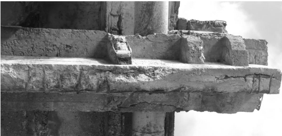
Рис. 5 – Характерні пошкодження консольної ділянки ригеля надарочної будови мосту у вигляді розтріскування та відшарування захисного шару бетону з оголенням та корозією арматури
