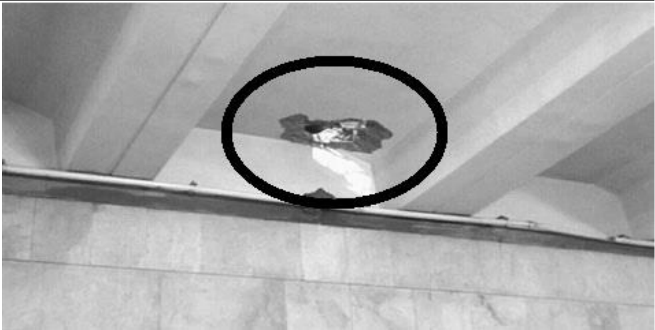
Рис. 2. Пошкодження конструкцій покриття споруди станції метрополітену
