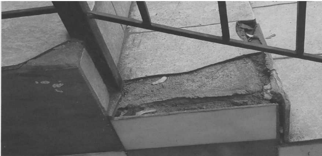
Рис. 1. Пошкодження ступенів сходів головного входу
