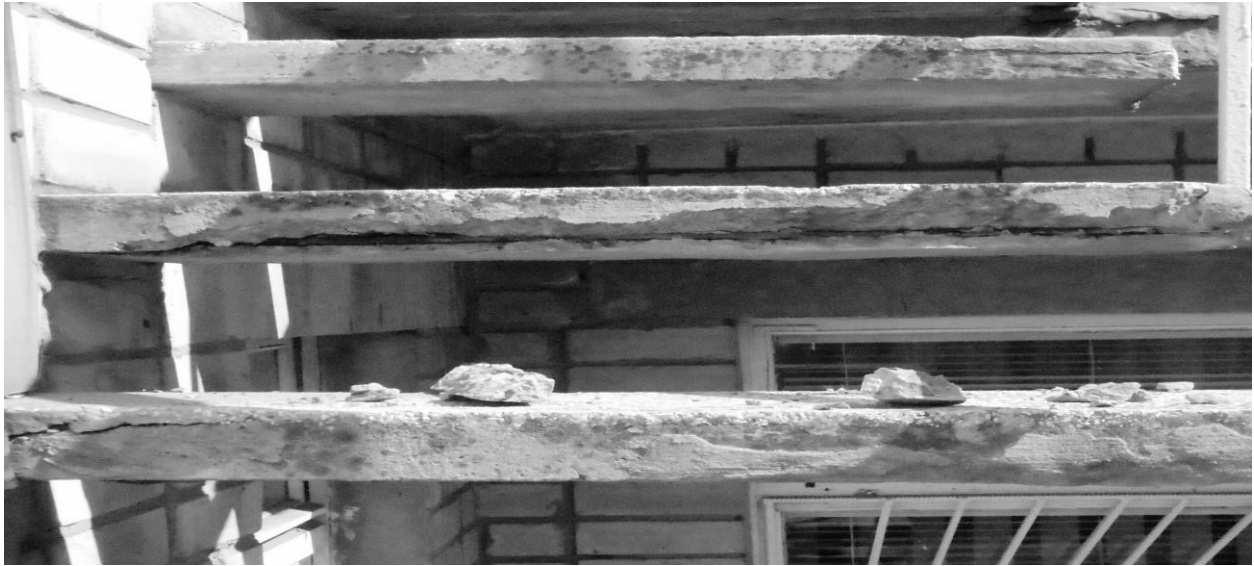
Рис. 3. Пошкодження залізобетонних сходинок евакуаційної галереї
