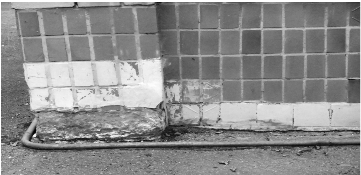
Рис. 5. Пошкодження цокольної частини стіни
