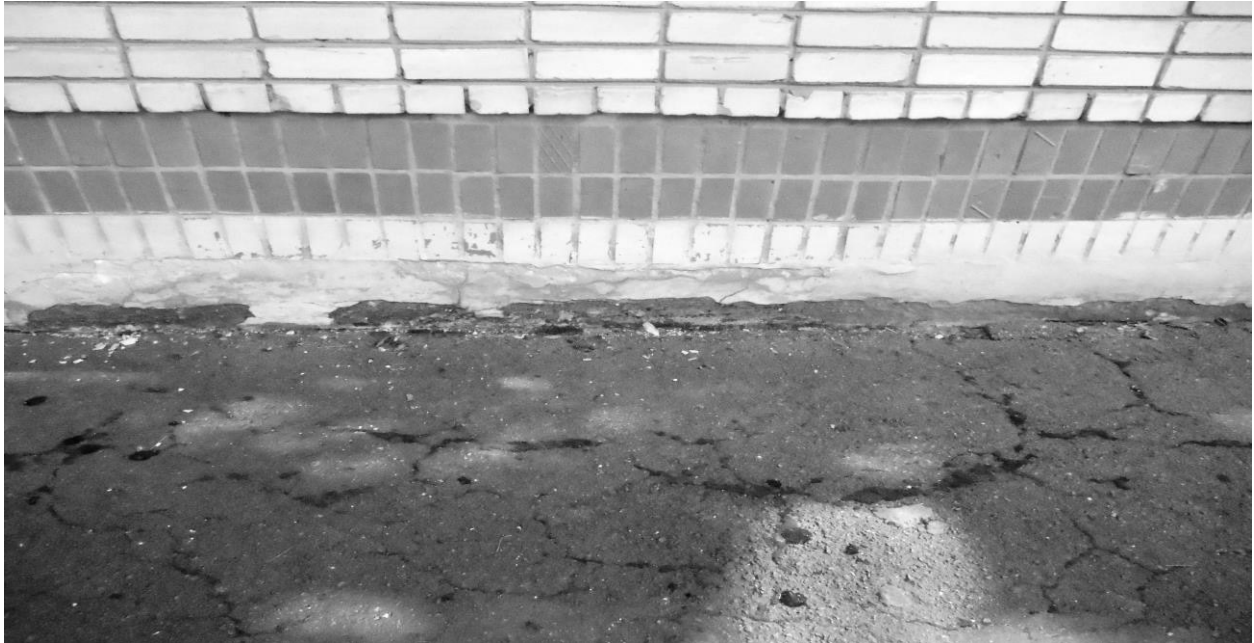
Рис. 4. Пошкодження вимощення (тріщини, деструкція асфальтобетону)
