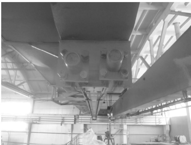
Рис. 1 – Создание предварительного напряжения в пролётной балке мостового крана грузоподъёмностью 10 т, пролётом 22,5 м
