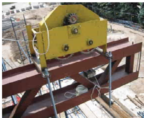
Рисунок 3. Общий вид вибромашины, установленной на конструкции.
