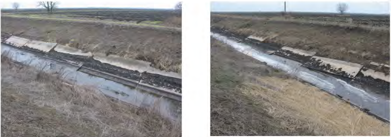
Рис. 4. Технічний стан МК-2 на ділянці ПК33+00-34+00
