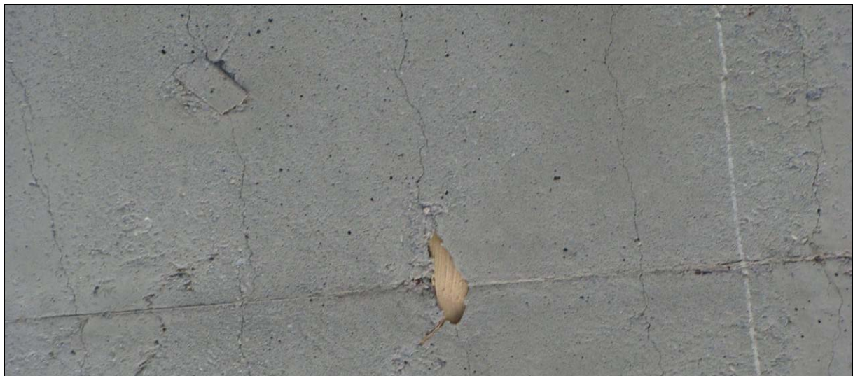
Рис. 2. Силкові тріщини з кроком 300...350 мм по нижній грані плити з шириною розкриття до 0,3 мм в прогонової будови з каркасним армуванням після зняття риштувань.
