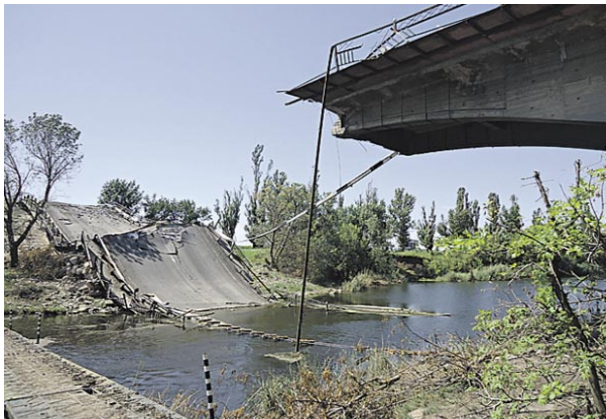
Рис. 1. Зруйнований терористами автодорожній міст
