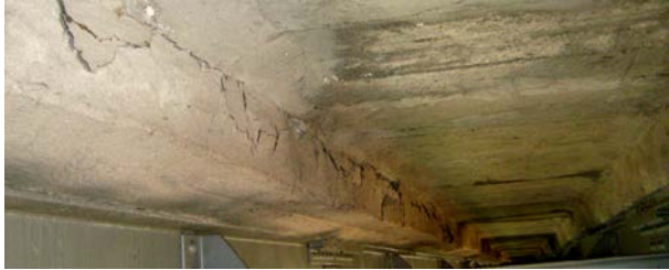
Рис. 9. Сколювання бетону, замокання по шву та по плиті з вилугуванням
