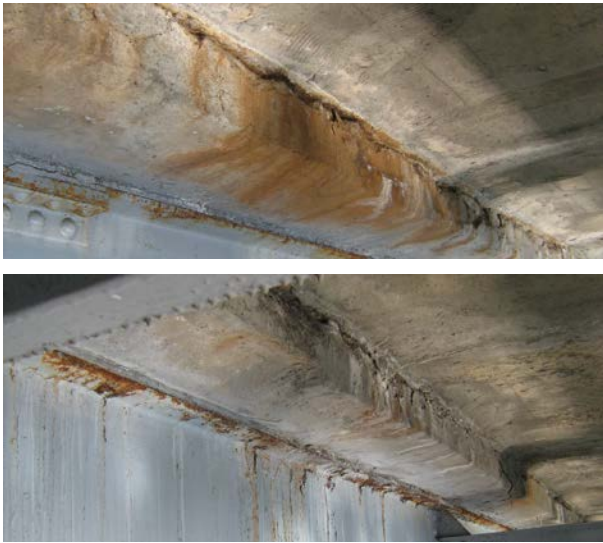
Рис. 13. Замокання та вилигування, тріщини, відшарування бетону
