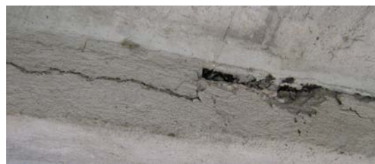
Рис. 8. Тріщини різного розкриття та сколювання
