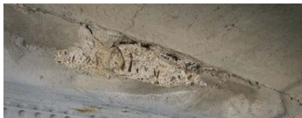
Рис. 10. Тріщини, відшарування бетону з оголенням арматури
