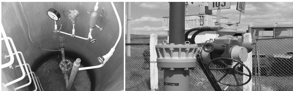
Рисунок 2 – Контрольний пункт системи телемеханіки на 986 км нафтопроводу
