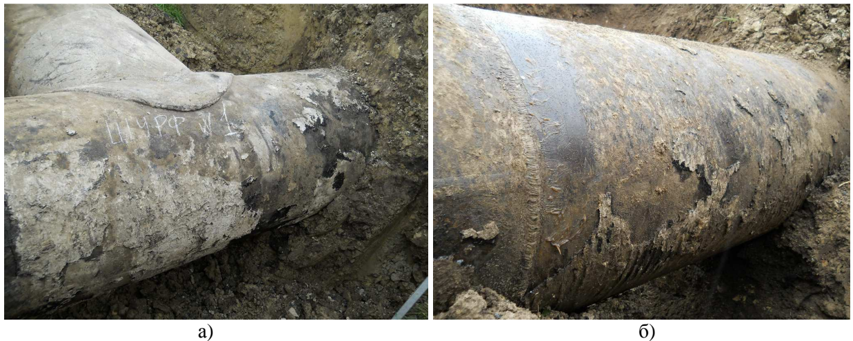
Рисунок 7 – Приклади руйнування ізоляційного покриття на підземній ділянці трубопроводу з великою площею пошкодження
