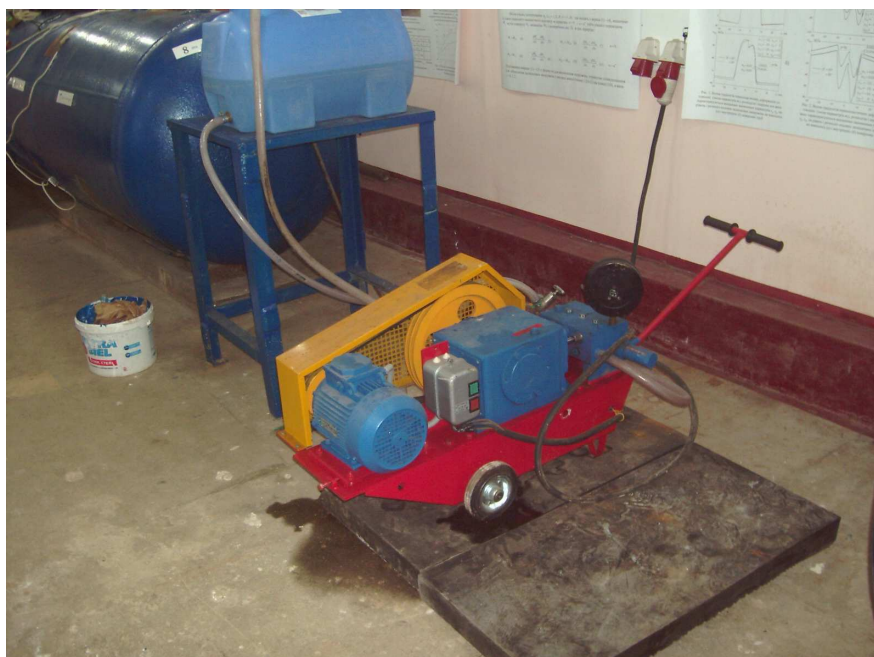
Рисунок 4 – Насосна станція дослідницького стенду
