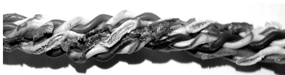
Рис. 8. Фотографія загальної деградації внутрішніх провідників кабелю UTP5e, розміщеного в слабопровідному ґрунті, після впливу МЭМИ
