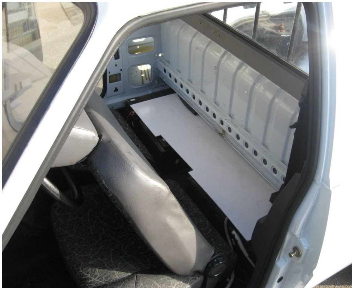
Рис.3. Размещение тяговой аккумуляторной батареи
