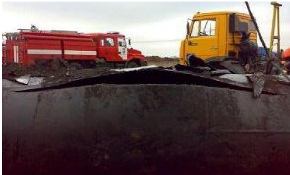
Рис. 1. Поздовжній розрив нафтопроводу "Дружба-1" діаметром 530 мм [9].
