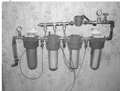
Рис.1. Загальний вигляд фільтруючого пристрою
