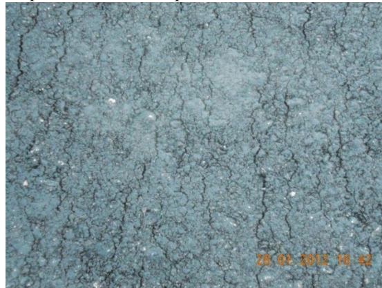
Рис 3. Руйнування верхньої оболонки покриття у вигляді волосяних мікротріщин
