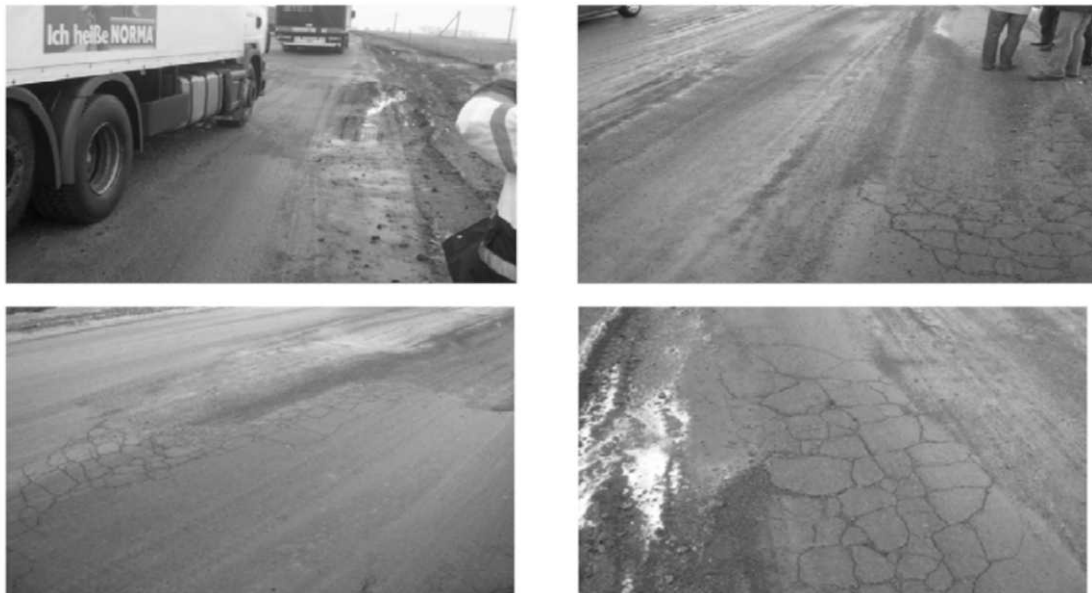
Рис.1. Характерні види руйнувань на дорозі М-06 (км 323+138 - км 339+000)
