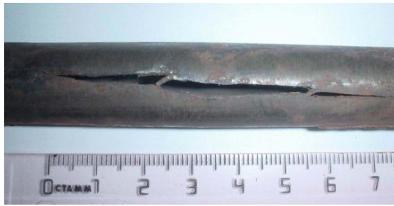
Рис. 5. Зовнішній вигляд руйнованої теплообмінної труби [3]
