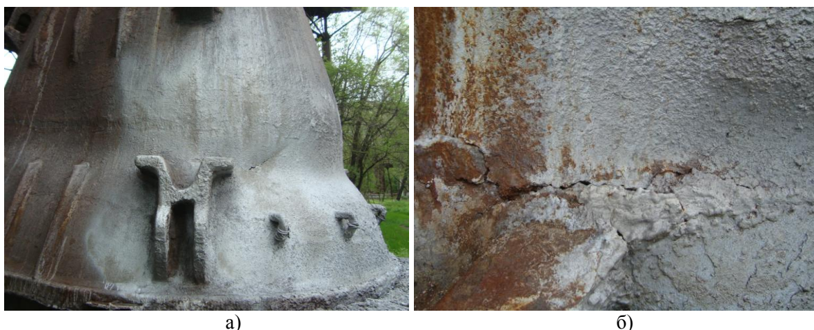
Рис.1. Деформация чаши шлаковоза (а) и трещины в месте наибольших прогибов стенки корпуса (б)
