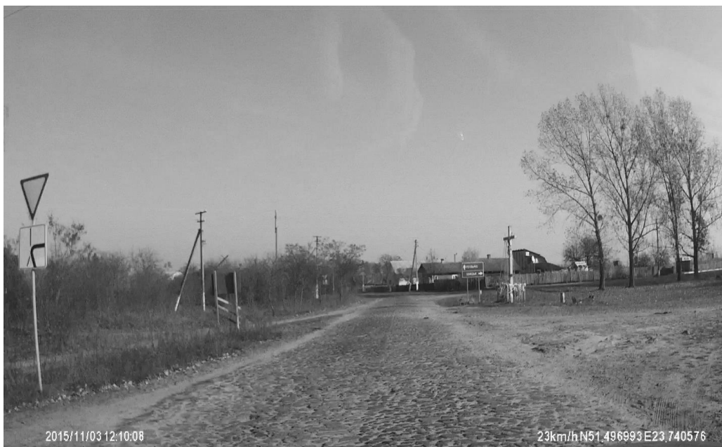
Рис. 2. Дефекти дорожнього покриття на ПК 145+70 а/д О 031696 Шацьк - Залісся - Грабове - Старовойтове - /М-07/
