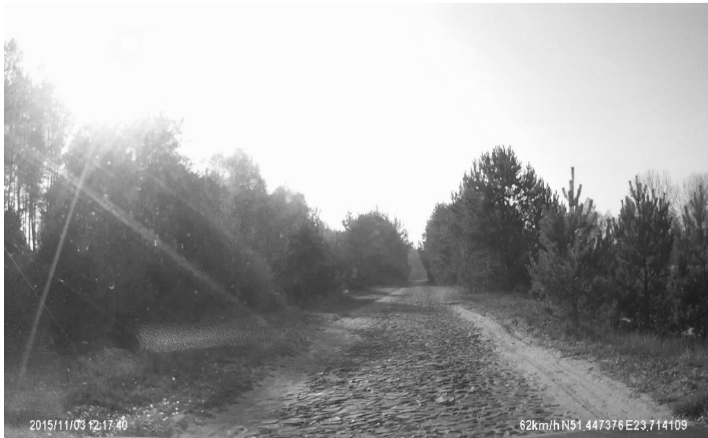
Рис. 3. Дефекти дорожнього покриття на ПК 205+34 а/д О 031696 Шацьк - Залісся - Грабове - Старовойтове - /М-07/
