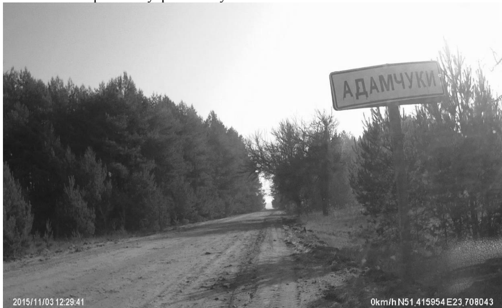
Рис. 4. Стан дорожнього покриття (нерівності покриття, неукріплене узбіччя) на ПК 252+38 а/д О 031696 Шацьк - Залісся - Грабове - Старовойтове - /М-07/
