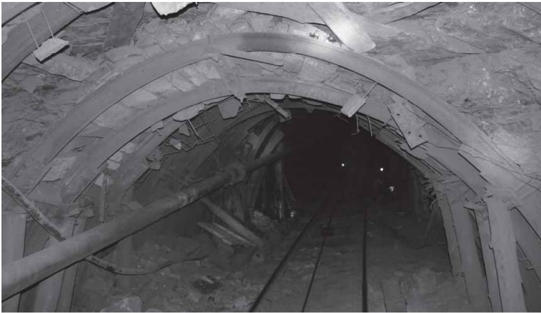
Рис. 2. Общий вид ходка до перекрепления
