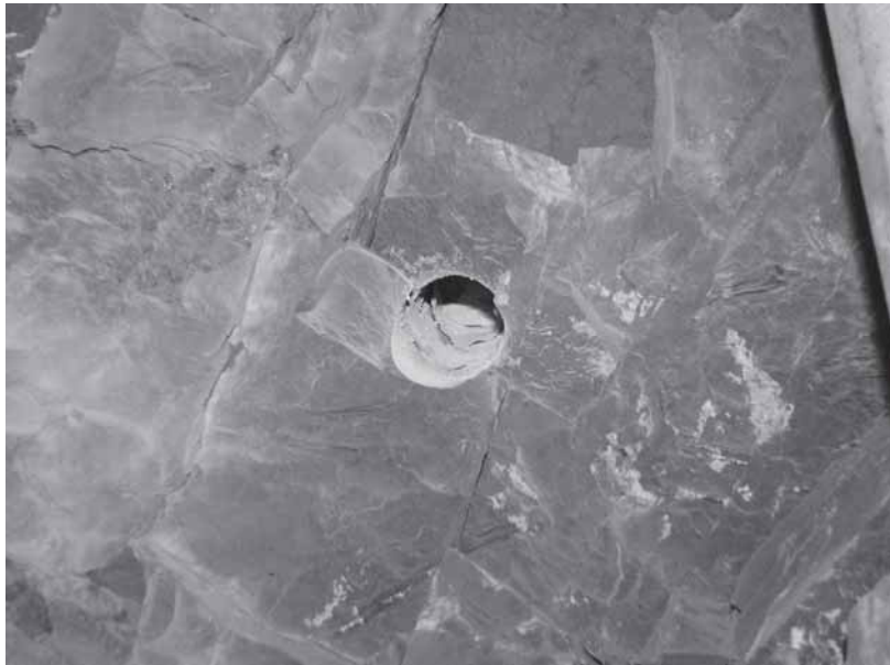
Рис. 7. Состояние поверхности кровли грузового ходка уклона пл. m_4^0 гор. 450 м вокруг шпура с НРВ после демонтажа деформированной рамы крепи
