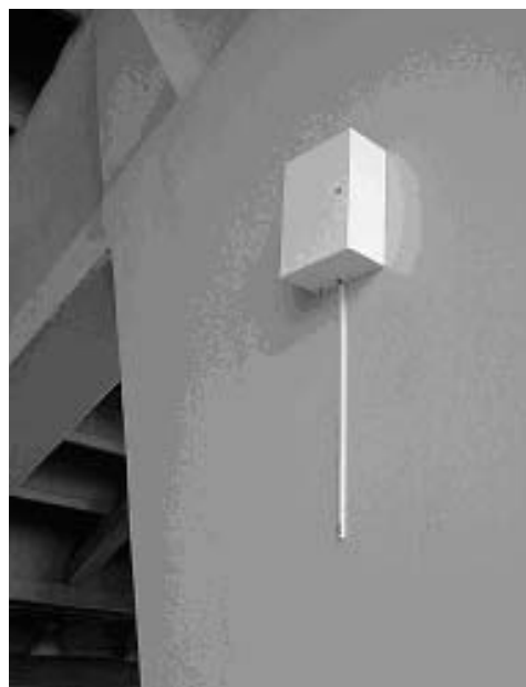
Рисунок 4. Датчик ВКВ-2 на опорі другого ярусу трибун
