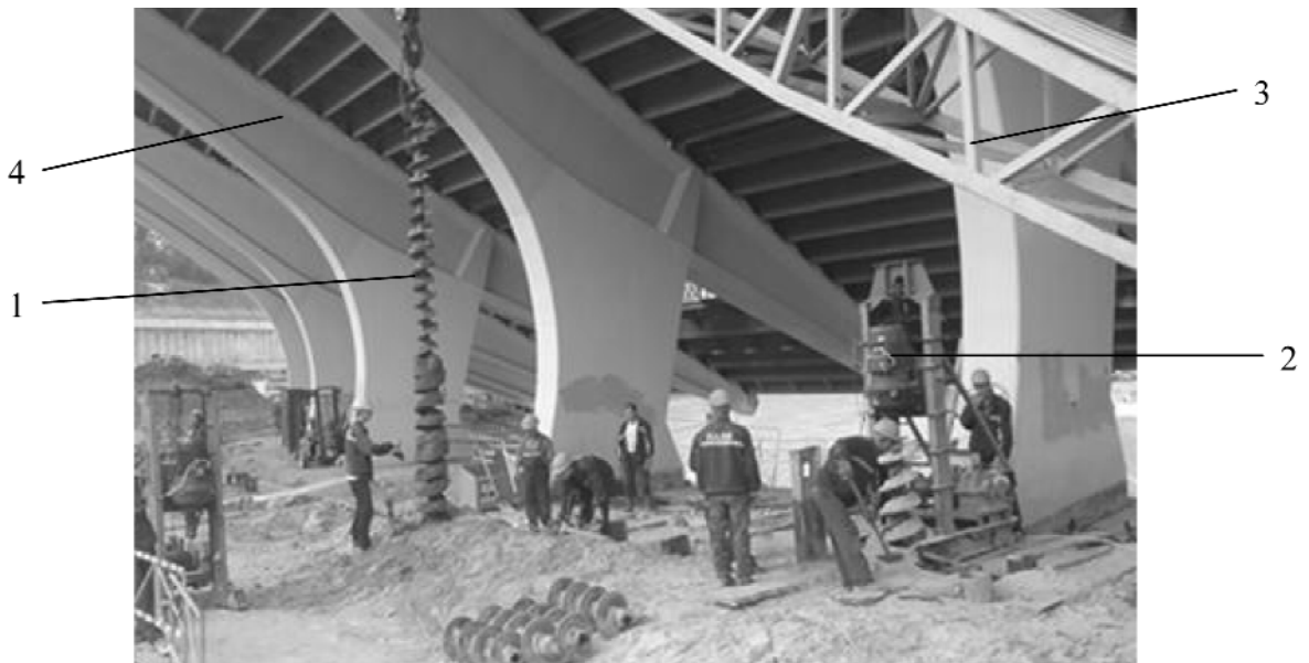
Рис. 4. Буріння свердловини та діставання шнекової колони зі свердловини: 1 – шнекова колона 2 – бурова установка РБУ-2М, 3 – стріла крана, 4 – пілон трибуни верхнього ярусу
