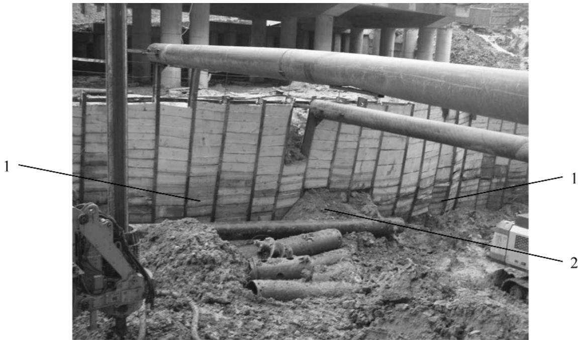
Рис. 6. Замокання та випадіння дощок забірки з вивалом ґрунту: 1 – місця замokання дощок забірки, 2 – випирання ґрунту
