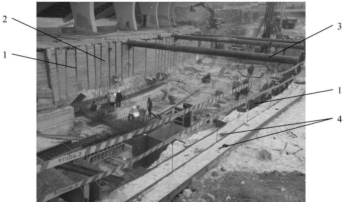
Рис. 3. Елементи огорожі котловану ХЗ: 1-стояк з двотавру №36М, 2-забірка з дощок товщиною 50 мм., 3-розпірка з металевої труби \varnothing 630 мм, 4-обв'язувальний пояс з двох двотаврів №36М
