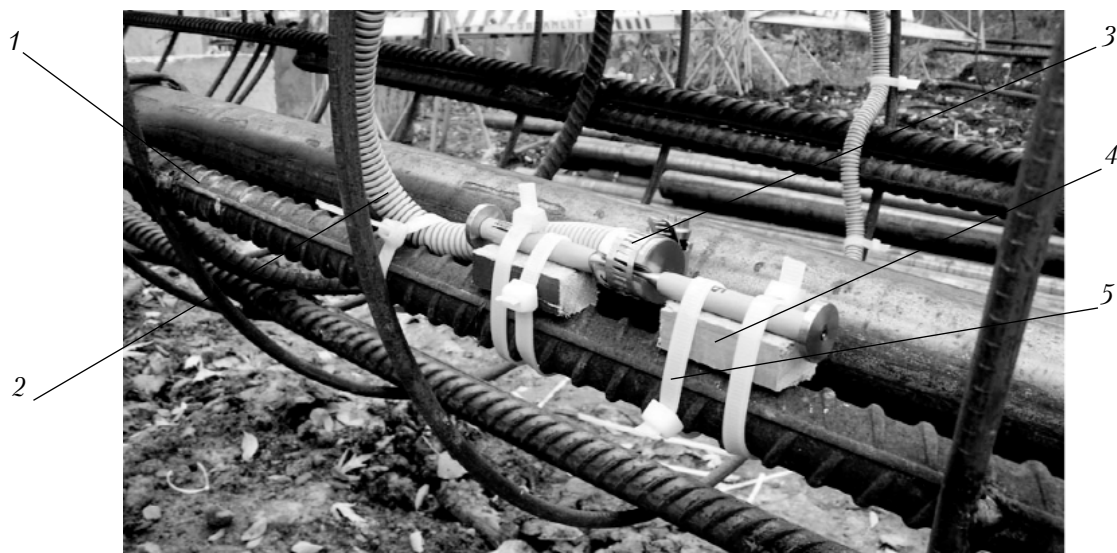
Рис. 5. Закріплені на армокаркасі контрольної палі датчик Geokon 4200: 1 – арматурний каркас контрольної палі, 2 – гофрована труба, 3 – датчик Geokon 4200, 4 – дерев'яна підкладка, 5 – нейлоновий хомут
