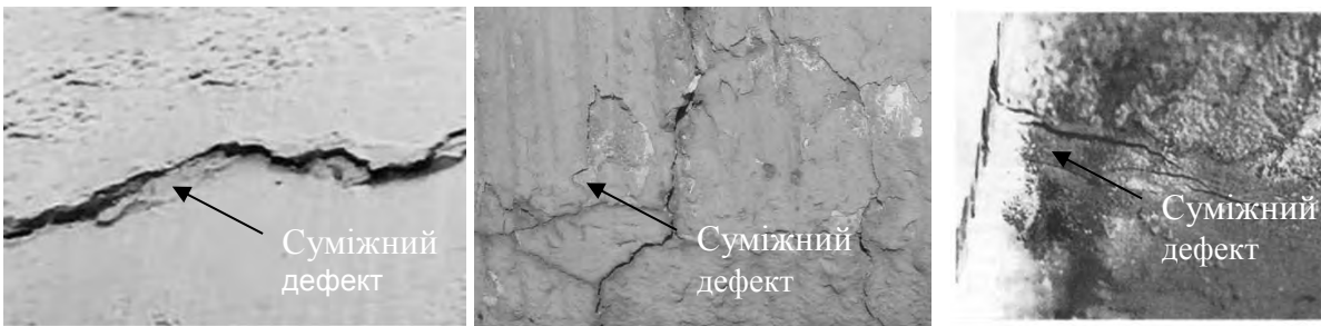
Рис. 1. Зображення тріщини та суміжних дефектів: а) просідання; б) розтріскування; в) корозія
