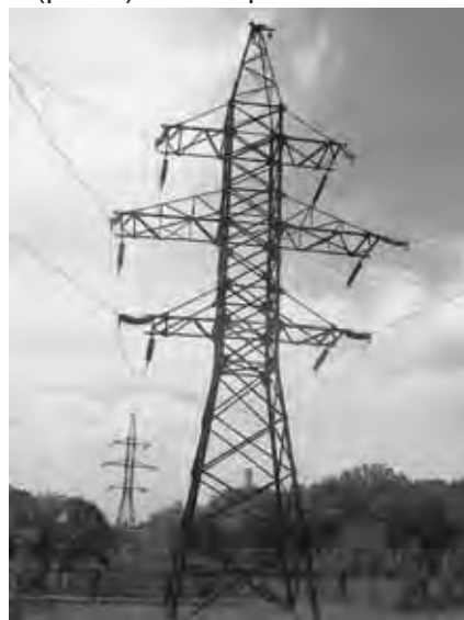
б) опора ВЛ 110 кВ
