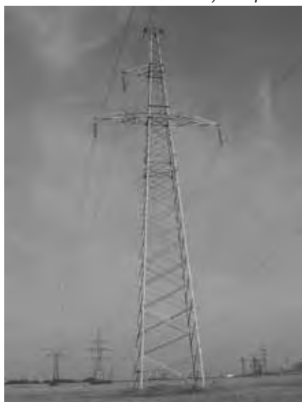
в) опора ВЛ 220 кВ
