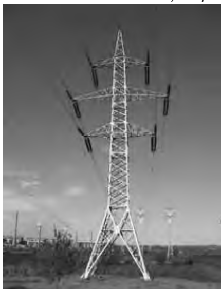
г) опора ВЛ 330 кВ
