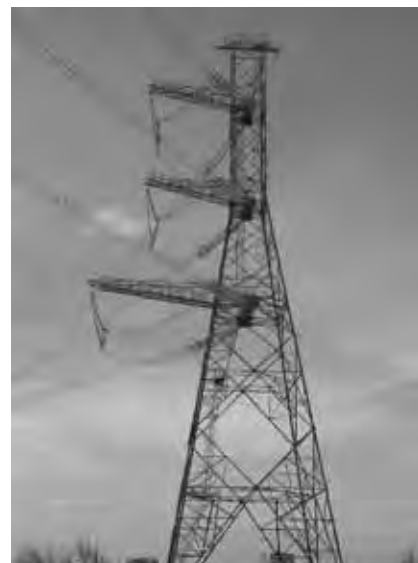
д) опора ВЛ 500 кВ
