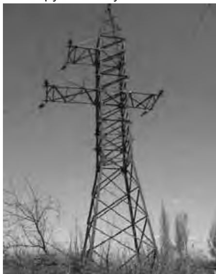
а) опора ВЛ 35 кВ
