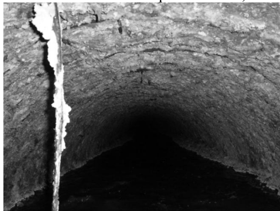
Рис. 1 – Коррозия обделки Орджоникидзевского коллектора в Харькове
