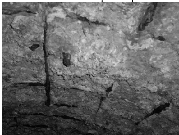
Рис. 2 – Разрушение вследствие коррозии первичного слоя обделки и начало коррозии несущего слоя
