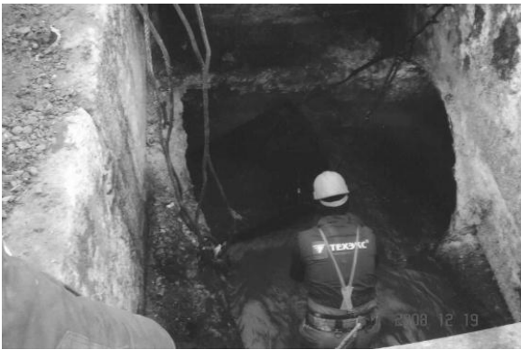
Рис. 4 – Разрушенный вследствие газовой коррозии свод Салтовского канализационного коллектора диаметром 2000 мм в Харькове
