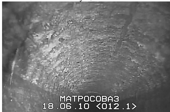
Рис. 3 – Коррозия стен канализационного коллектора диаметром 2000 мм по ул. Матросова в Харькове
