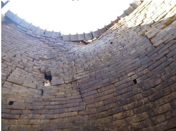
Рис. 5 - Состояние футеровка оголовка трубы 9-го яруса в уровне оголовка.
