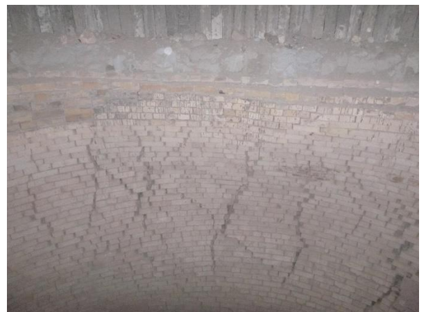
Рис. 4 - Сетка силовых трещин шириной раскрытия до 80мм, выход из плоскости кладки футеровки ствола трубы 1-го яруса с отм. 16.00м до отм. 20.00м.
