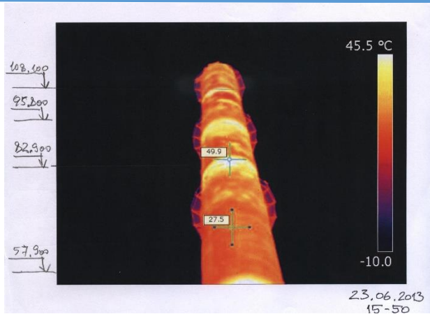
Рис. 2 - Термограмма поверхности ствола железобетонной дымовой трубы после взрыва.
