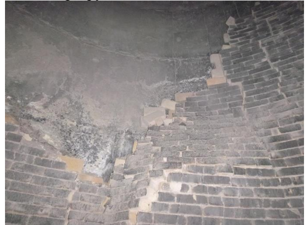
Рис. 3 - Полное разрушение футеровки и теплоизоляции ствола трубы в уровне карниза 7-го яруса.
