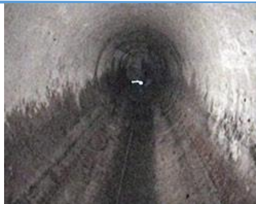
Рис. 2 - Теледиагностика стальной водопроводной магистрали d=500 мм
