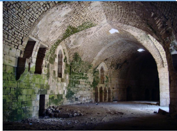
Рис.1 - Каменные своды большого зала крепости Аль-Хосн разрушающиеся в результате просачивания воды.
