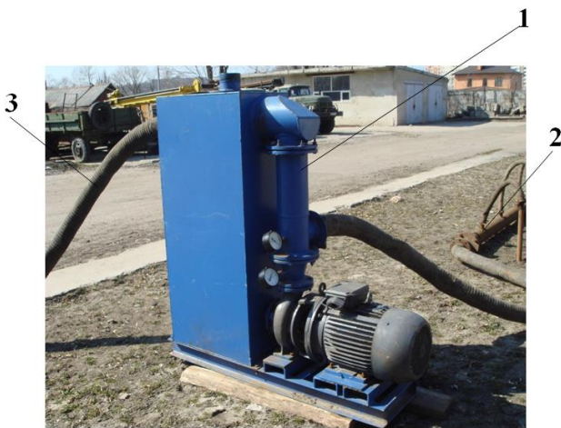
Рис. 1. Общий вид установки ПУВВ-5МЕА: 1 – приводная станция установки; 2 – линейная всасывающая система с иглофильтрами; 3 – сливная линия
