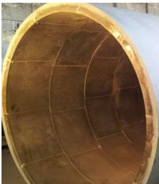
Рис. 7. Трубопровод с защитой внутренней поверхности плитами из базальта
