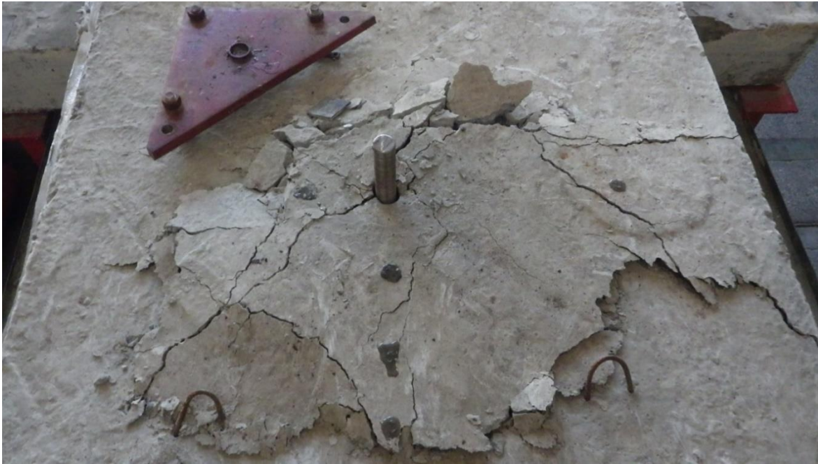
Рис.14. Разрушение плиты П2 –б от среза при продавливании
