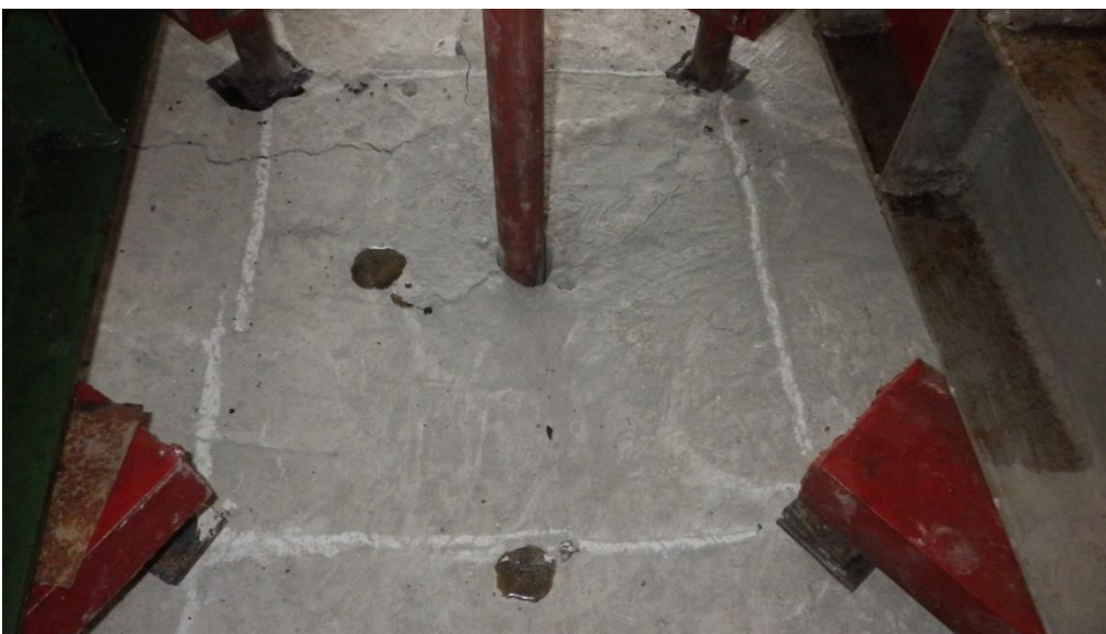
Рис.18. Разрушение плиты П2 от совместного воздействия изгиба и среза при продавливании
