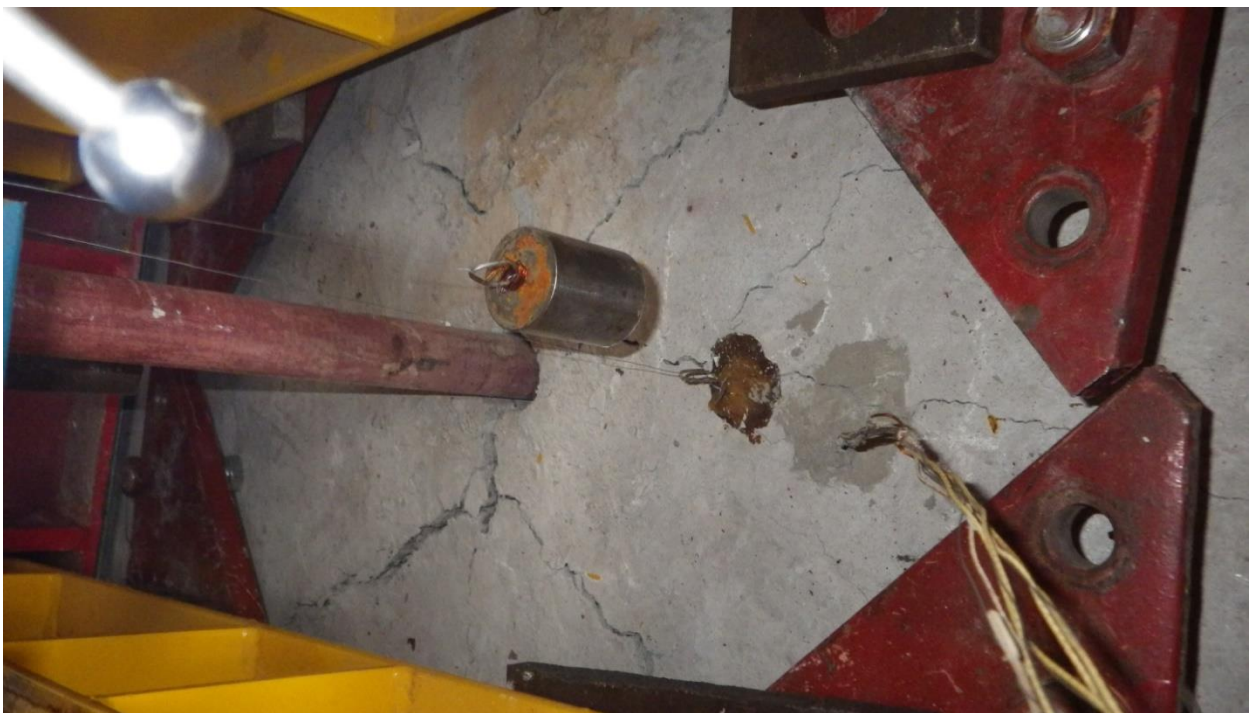
Рис.20. Разрушение плиты ПЗ от совместного воздействия изгиба и среза при продавливании
