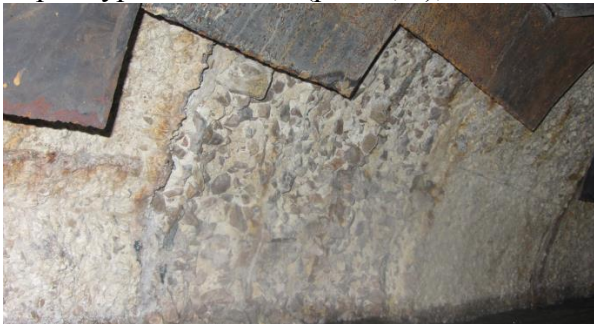
Рис. 7. Коррозия бетона и арматуры тубинга
