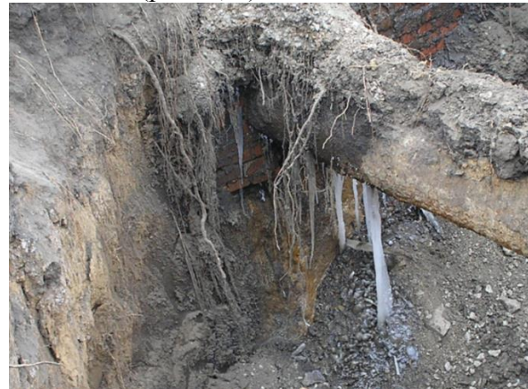
Рис. 1. Первичная стадия проседания грунта в зоне повреждения коллектора
