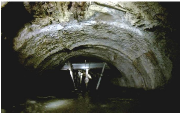
Рис. 8. Общий вид коллектора с разрушенным коррозией сводом
