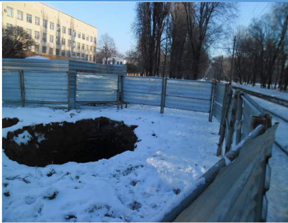
Рис. 2. Обрушения в зоне повреждения коллектора после засыпки грунтом первичного проседания грунта
