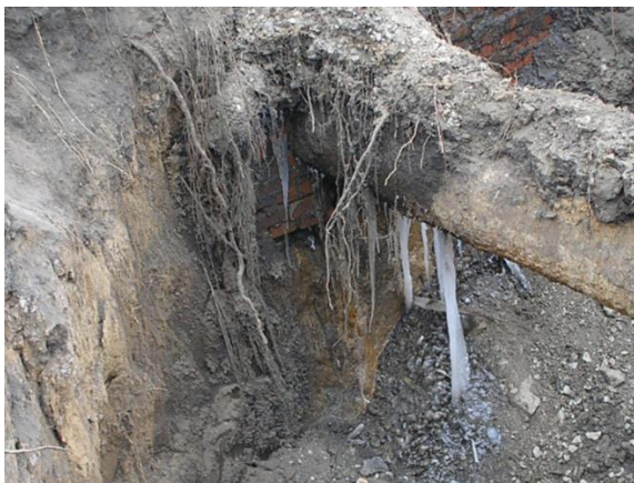
Рис. 5. Первичная стадия проседания грунта в зоне повреждения коллектора
