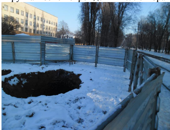
Рис. 6. Обрушение в зоне повреждения коллектора после засыпки грунтом первичного проседания грунта
