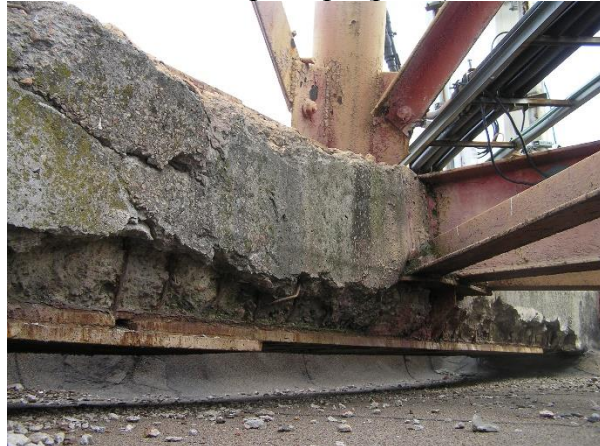
Рис. 3. Разрушение обетонировки металлических балок рамы на глубину до 100мм, оголение и коррозия хомутов до 100%.
