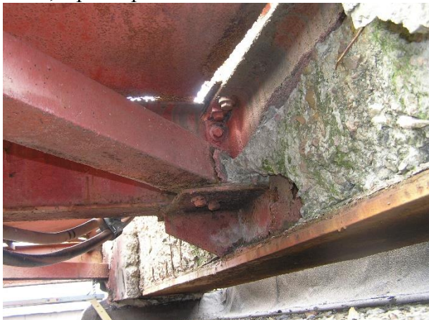
Рис. 4. Разрушение бетона на глубину до 100мм, оголение и коррозия хомутов до 100%, сквозная коррозия металлического настила.
