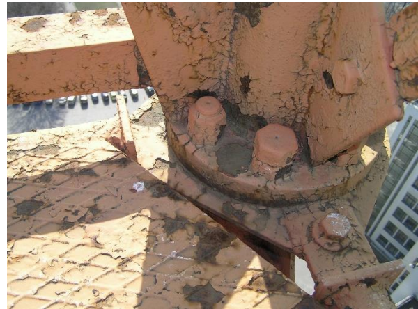
Рис. 2. Состояние металлоконструкций башни на отм. 75.50м.
