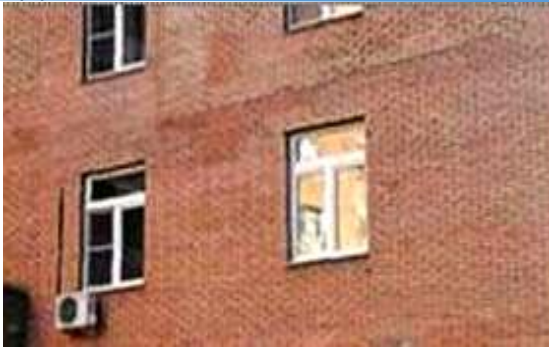
Рис.3. Сліди ремонту теплоізоляції
