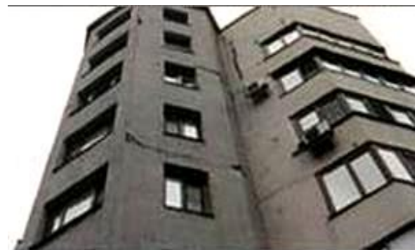
Рис.2. Обвалення зовнішнього оздоблення будинку з пінобетонних блоків
