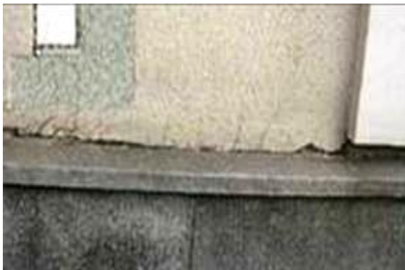
Рис.5. Стики з не утеплювальною поверхнею будівлі через температурний шов
