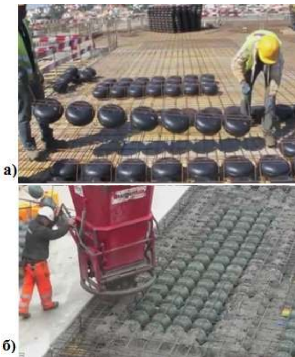
Рис. 7. Устройство облегченных железобетонных перекрытий по технологии Sobiax: а) установка арматурных каркасов со вставленными вкладышами; б) бетонирование плиты
