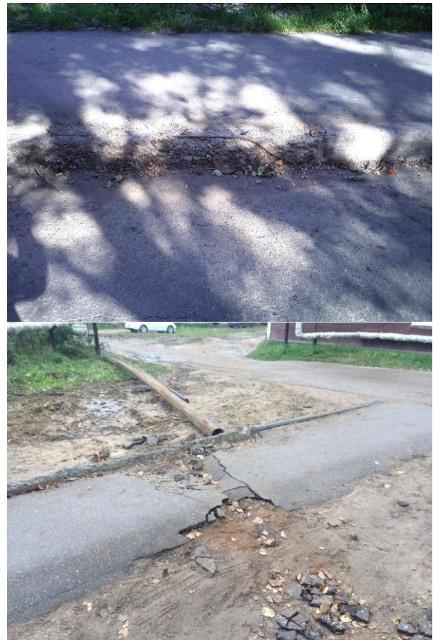
Рис.1. Последствия разрушения бордюрного камня
