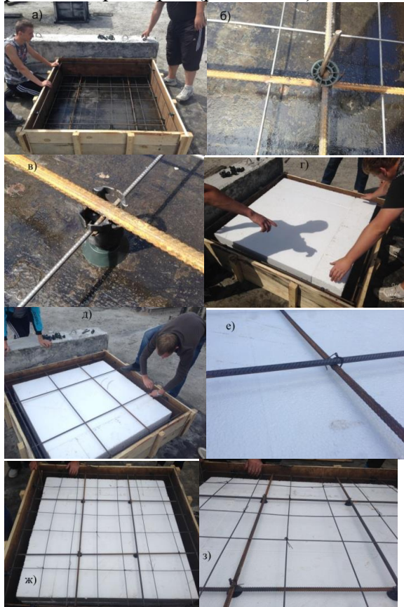
Рис. 2. Технология фиксации арматурных каркасов и вкладышей при устройстве горизонтальных элементов облегченных конструкций: а) – установка арматурного каркаса в проектное положение; б) – конструкция сетки нижней обшивки для фиксации вкладыша; в) – фиксатор, обеспечивающий толщину защитного слоя для нижней сетки; г) – установка вкладыша в проектное положение; д) – элементы жесткости верхней сетки для удержания вкладыша в проектное положение; е) – соединение арматурных стержней вязальной проволокой; ж) – конструкция верхней сетки; з) – фиксация вкладыша за счет верхней сетки
