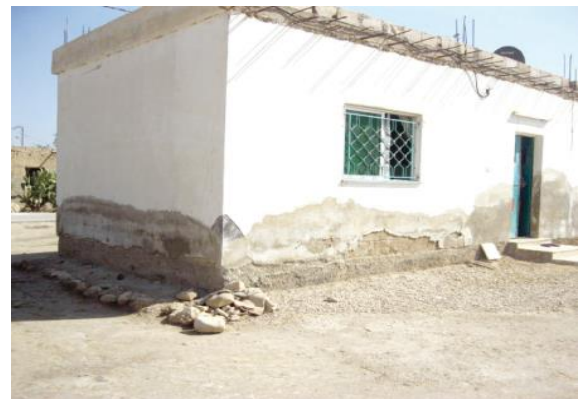
Рис. 3. Последствия почвенной коррозии в Иордании.
