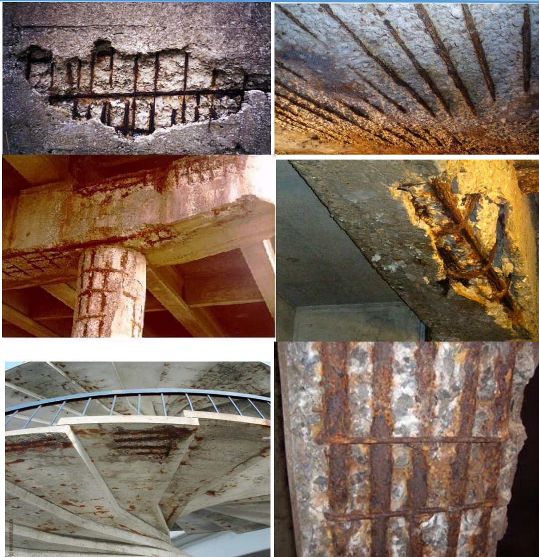
Рис. 4. Коррозионные разрушения железобетонных конструкций в несущих конструкциях Иордании.
