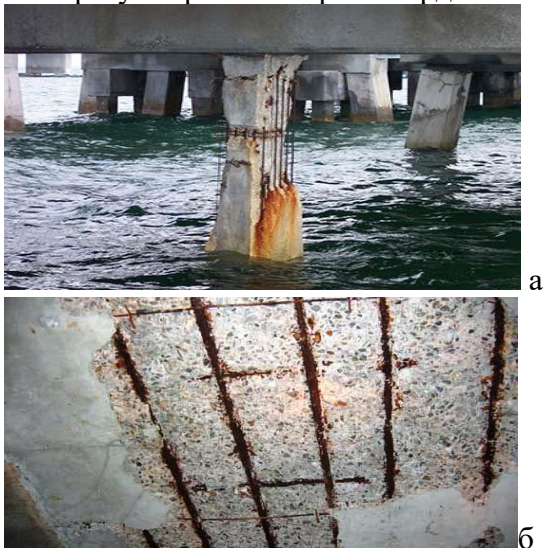
Рис. 6. Характер разрушения железобетонных конструкций в морской среде: а-железобетонный столб; б- железобетонная плита.
