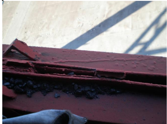
Фото 4. Металлическая ферма верхнего пролета. Разрушение сварных швов между прокладками (сухариками) и парными уголками нижнего пояса.
