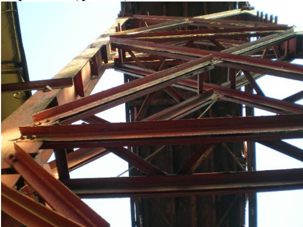
Фото 3. Металлическая маятниковая колонна. Элементы крестовой решетки усилены уголками, распучивание между уголками решетки и полками ветвей колонн (фасонками).
