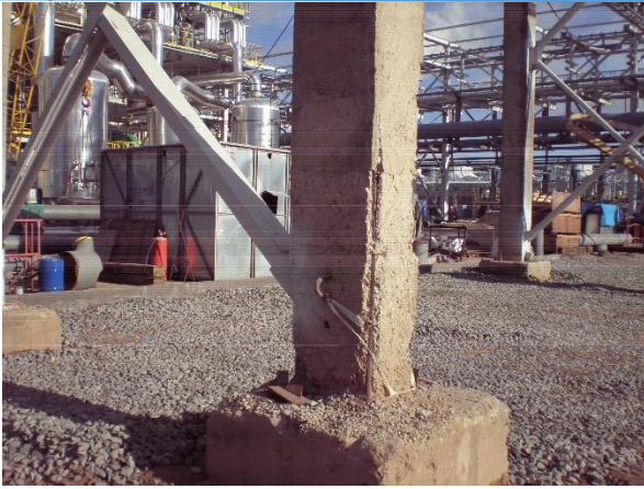
Фото 2. Железобетонная колонна эстакады. Разрушение защитного слоя бетона вдоль рабочей арматуры, оголение и коррозия арматуры до 5%.
