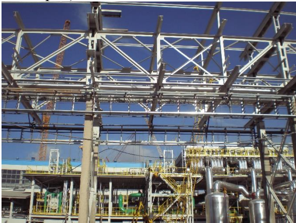
Фото 5. Металлические связи по нижнему поясу ферм пролетных строений вырезаны.
