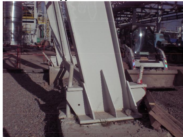
Фото 3. Узел опоры металлической колонны на фундамент. Гайки на анкерных болтах отсутствуют, отсутствует цементная подливка под опорным листом колонны.
