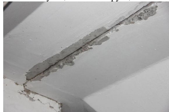
Рис. 6. Нарушение целостности конструкции силоса, вызванное просадкой колонны
