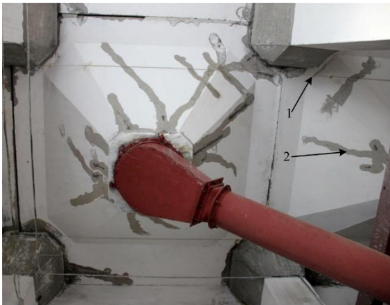
Рис. 4. Расположение трещин на днище
