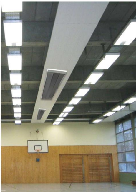
Рис. 4. Инфракрасное отопление спортивного зала с помощью электрических трехпанельных длинноволновых нагревателей Билюкс [1].
