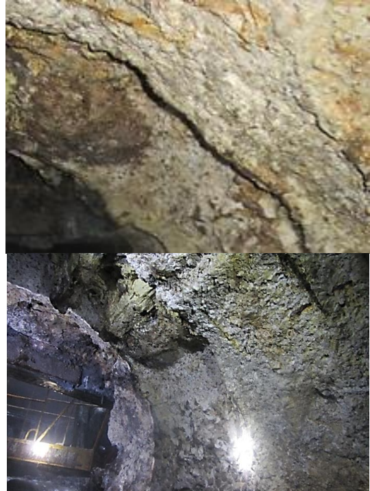
Рис. 2. Внутренняя поверхность канализационных тоннелей, разрушенная коррозией
